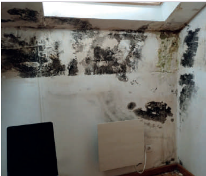
Estado de humidade no que se atopaban as paredes do inmoble.
